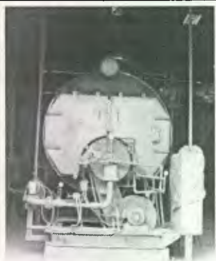
FOTO 5. CALDERA DE 300 BHP DE GAS
