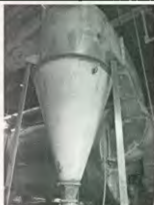
FOTO 7. CICLÓN DE LA CALDERA DE 300 BHP DE CARBÓN
