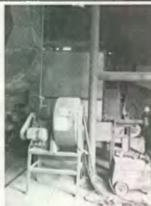
FOTO 8. FILTRO DE LA CALDERA DE 300 BHP DE CARBÓN
